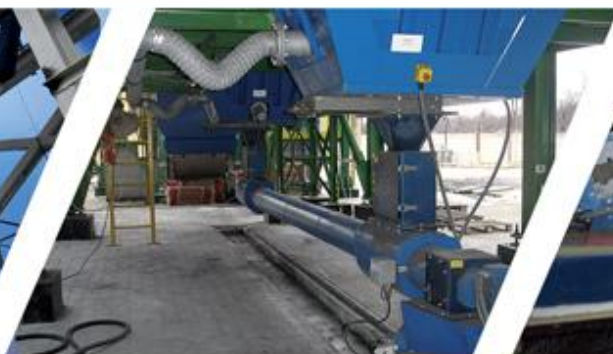
Instalacja transportu pyłu
